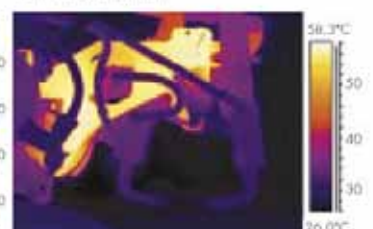
焊接设备内的热点
